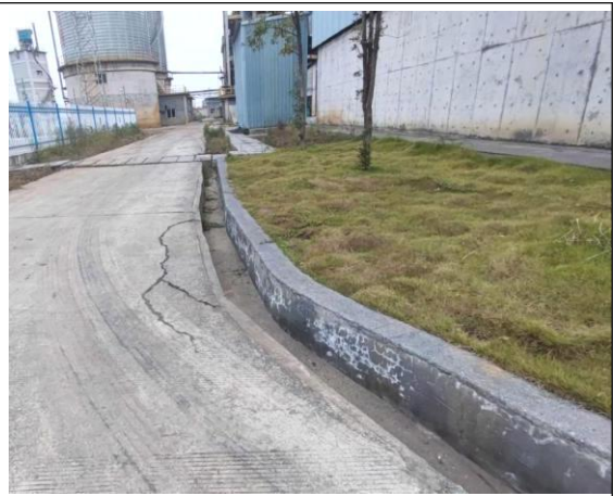
变电站东侧排水沟及绿化
